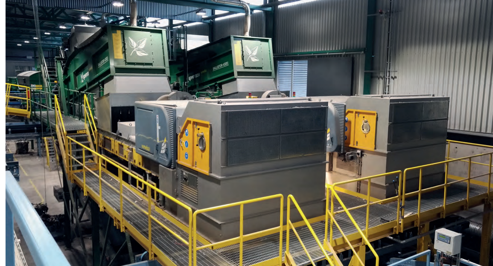
LATE-lajittelulaitos erottelee jätteestä arvokkaat materiaalit uudelleen hyödynnettäviksi. Ballistinen erotin erottelee jätettä muodon mukaan 2D- ja 3D-jakeisiin. Optinen erottelu jakaa arvokkaat materiaalit, kuten kuidut ja muovit omiin jakeisiinsa.
